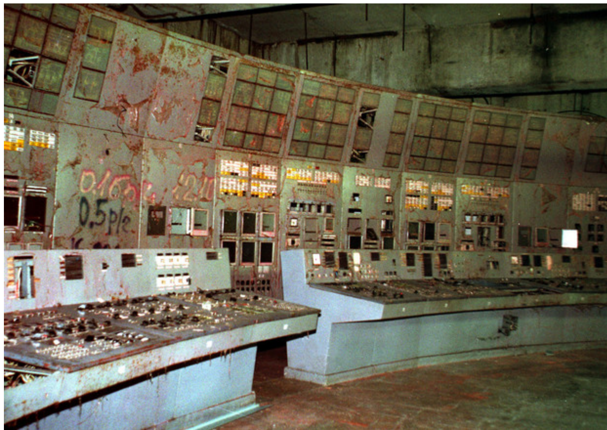
1/13 Blick in den zerstörten Kontrollraum, in dem sich die Schichtleiter am 26. April 1986 zu einem verhängnisvollen Experiment hinreissen liessen. Sie koppeln die Anlage vom Sicherheitssystem ab. Plötzlich steigt die Leistung des Reaktors massiv an. KEYSTONE
